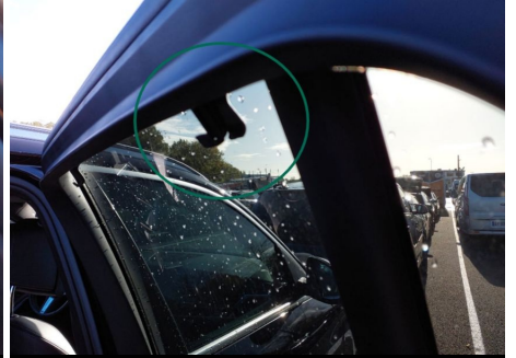
Support de pare-soleil / Avant Droit / Cassé
